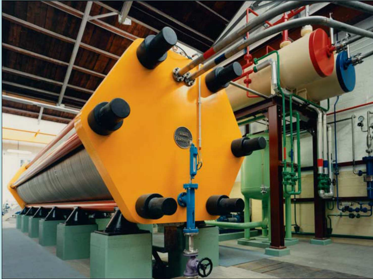
Moderner 30 bar – Druckelektrolyseur der Firma Elektrolyse-Technik GmbH mit einer Kapazität von 760 m 3 /h ( ~ 3,5 MW el ); Foto: ELT GmbH
