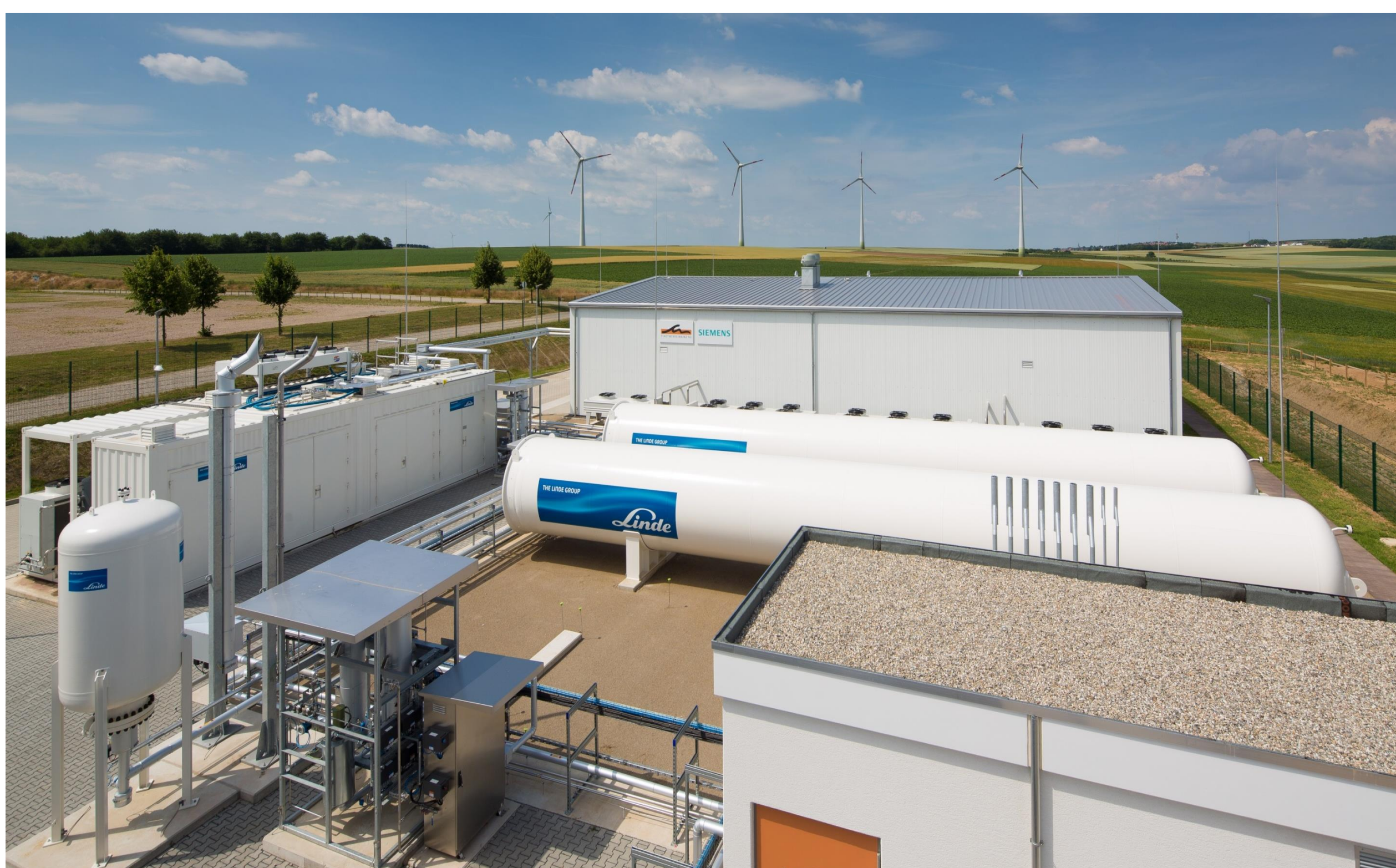
Foto: Die Power-to-Gas-Anlage der Stadtwerke Mainz. (Copyright: Energiepark Mainz)
